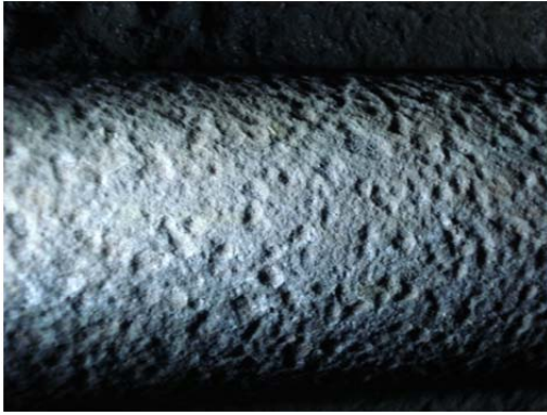
Figura 24- Superfície externa de um tubo de um economizador que operou abaixo do ponto de orvalho dos gases.
