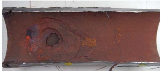
Figura 4 - "Perda de espessura" na superfície interna do tubo, somente pode ser detectada indiretamente por ENDs.
