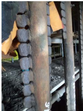
Figura 3 - "Perda de espessura" na superfície externa do tubo, que pode ser detectada visualmente pelo inspetor
