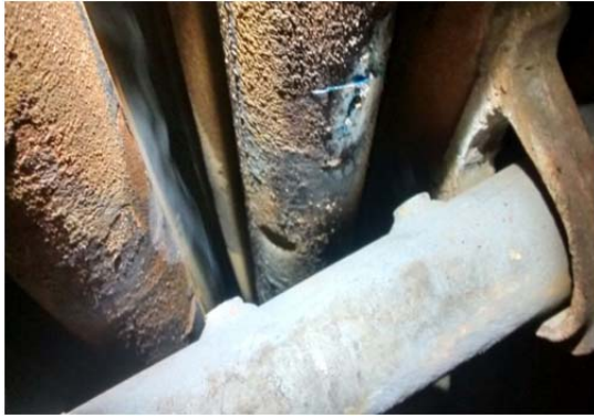
Figura 21- Tubo desgastado por corrosão-erosão do vapor/condensado injetado através da lança do ramonador
