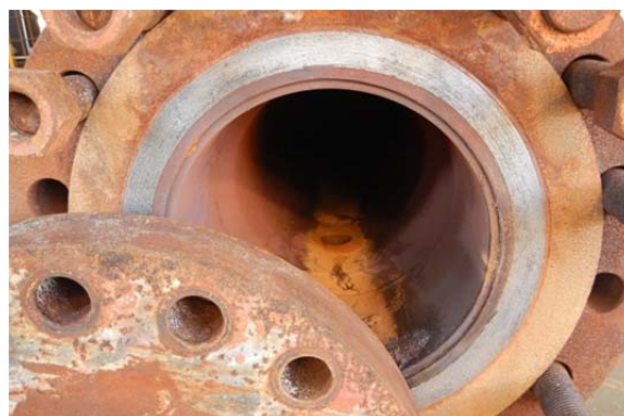
Figura 6 - Depósitos e produtos de corrosão observados no interior de um coletor da parede d'água da caldeira
