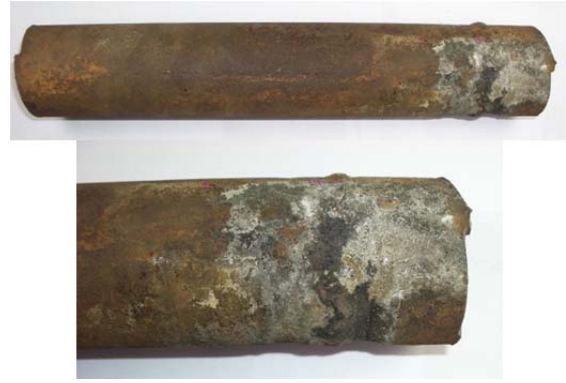
Figura 25- Perda de espessura causada pela formação de ácidos produzidos pela reação da água usada na limpeza e as cinzas
