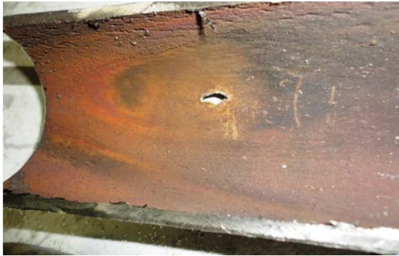
Figura 11 - Perda de espessura interna em um "grande área", que pode ser detectada facilmente por IRIS..
